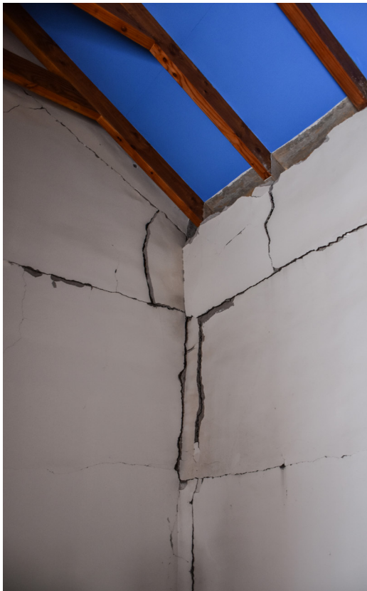
Detalle de interior con fisura en esquina.
