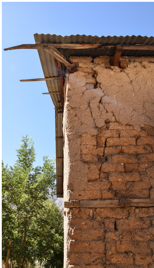
Detalle de tabique testero, desprendimiento de revestimiento exterior (adobe).
