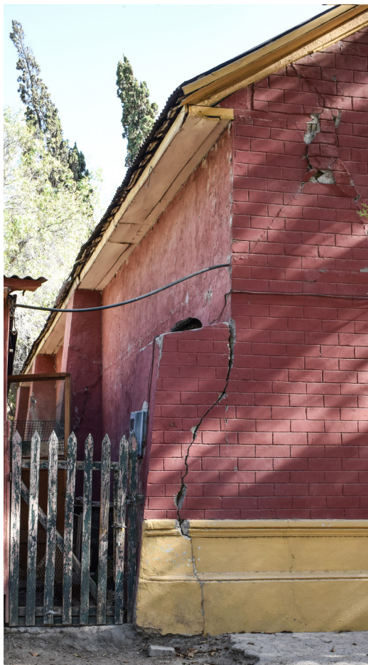
Detalle exterior de fisuras laterales.
